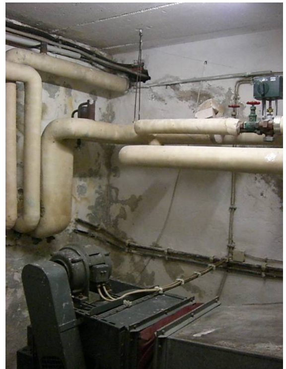
Die Heizungs- und Lüftungsanlage der Kirche ist renovierungsbedürftig.
