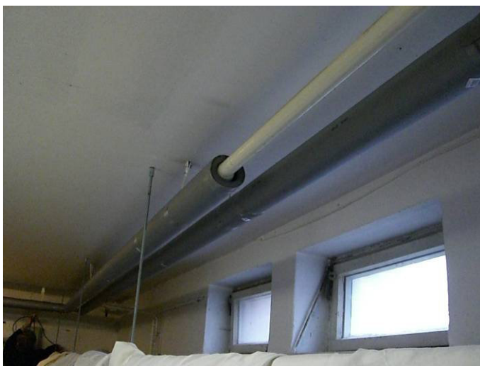
Wärmeisolierung der Heizungsrohre in den Kellerräumen, 2011.
